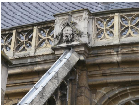
La balustrade du chevet sud à restaurer
