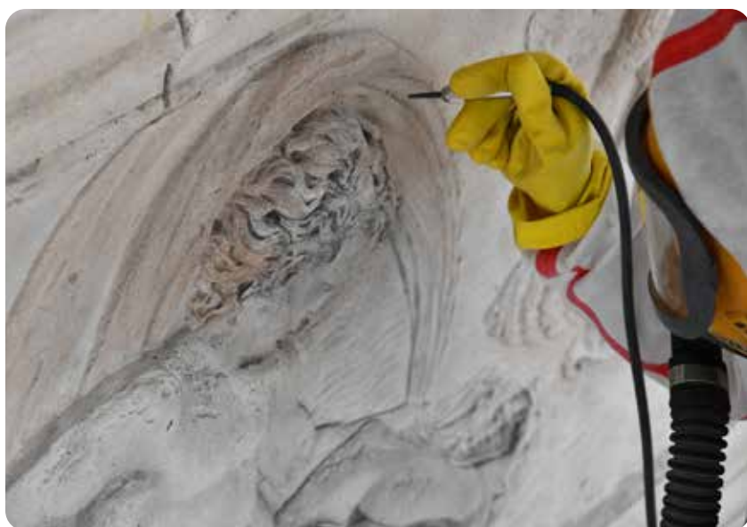
Nettoyage de l'attique de la façade est au microsablage © J-M Moser/COARC/Ville de Paris
