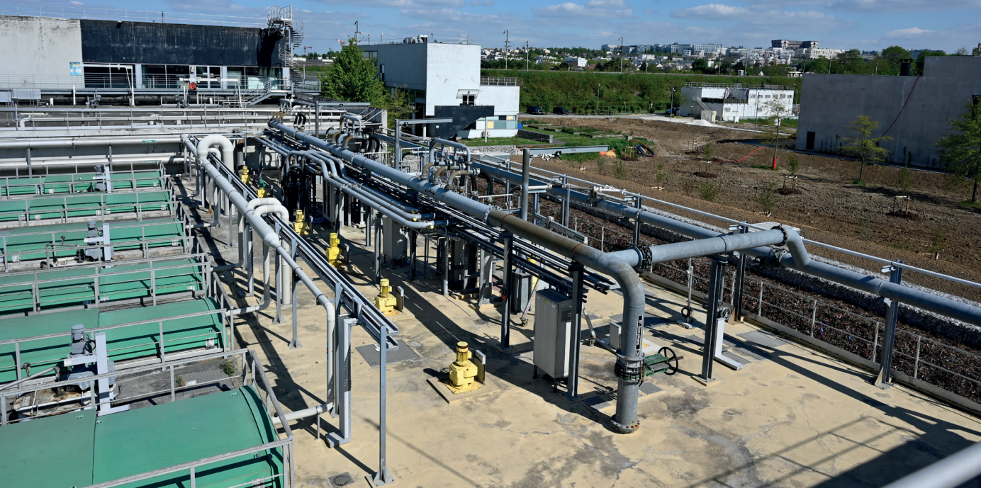
Station d'épuration de Noisy-Le-Grand Crédit: SRCI
